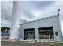
水素利用設備
