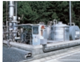
■溶剤回収ROユニット
