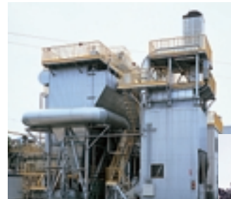
■RDFボイラー
