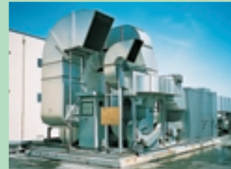
■濃縮・脱臭処理装置
