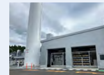
水素利活用設備
