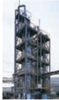
■ Reuse (rectification) unit
